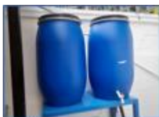
Ilustración 7 Foto –Sistema de recolección de agua lluvia
