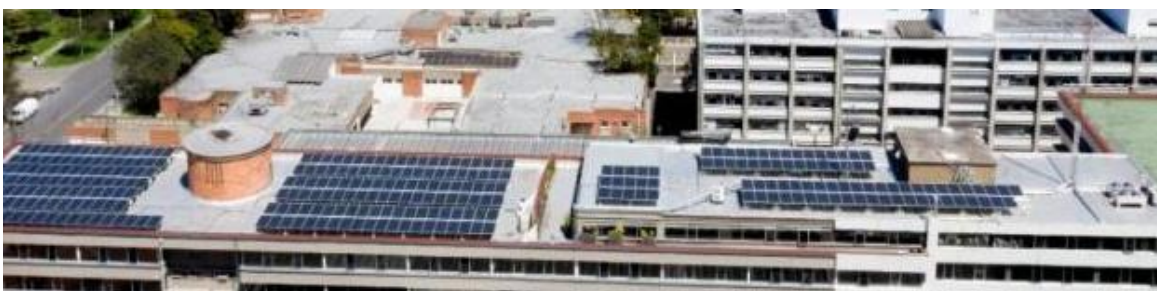
Ilustración 6 Foto - Paneles solares sede principal
