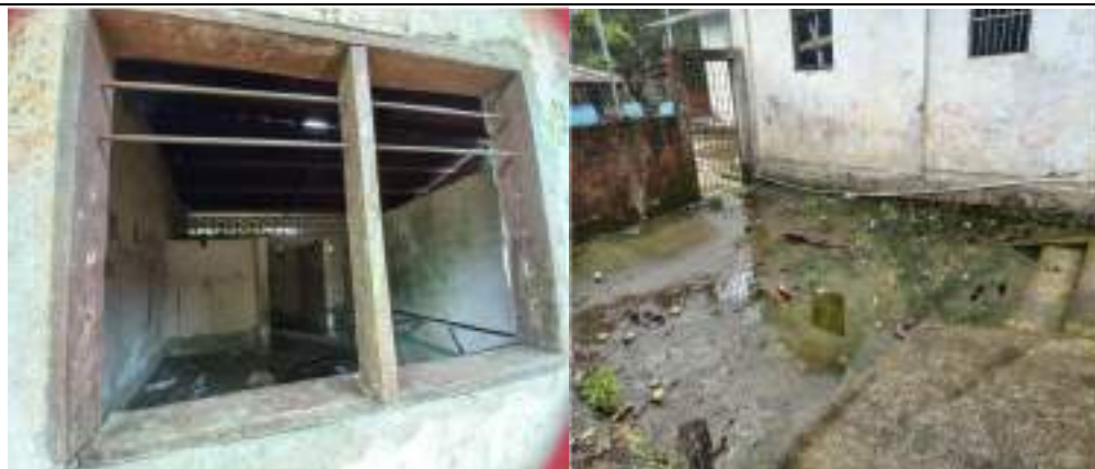
Fuente: Defensoría del Pueblo, imágenes del estado físico de IE zona rural Bagadó
