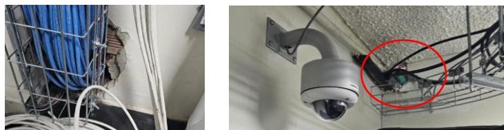
Fuente: Imágenes tomadas en data center.
