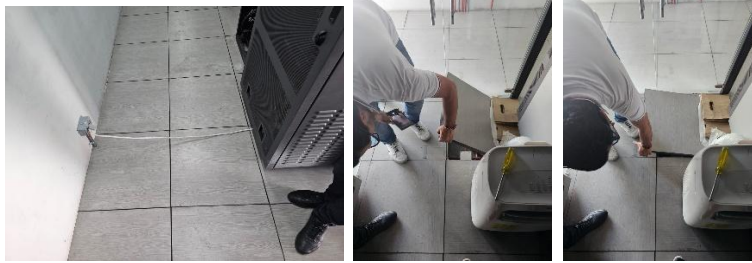
Fuente: Imágenes tomadas en data center alterno.
