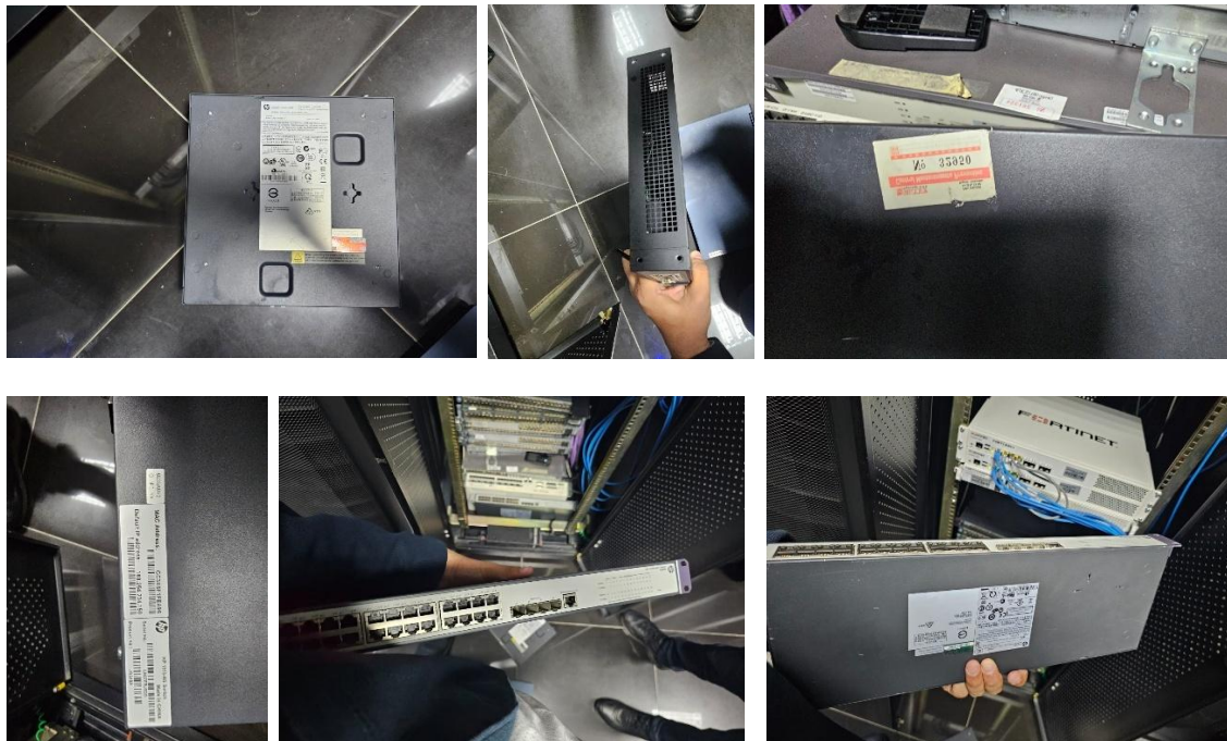
Fuente: Imágenes tomadas en data center.
