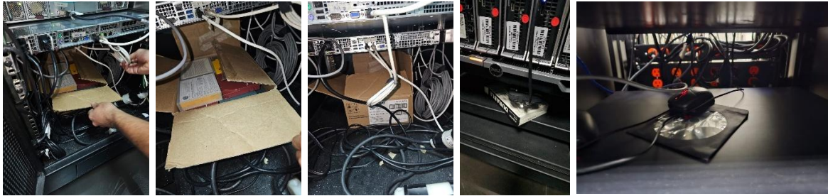
Fuente: Imágenes tomadas en data center.
