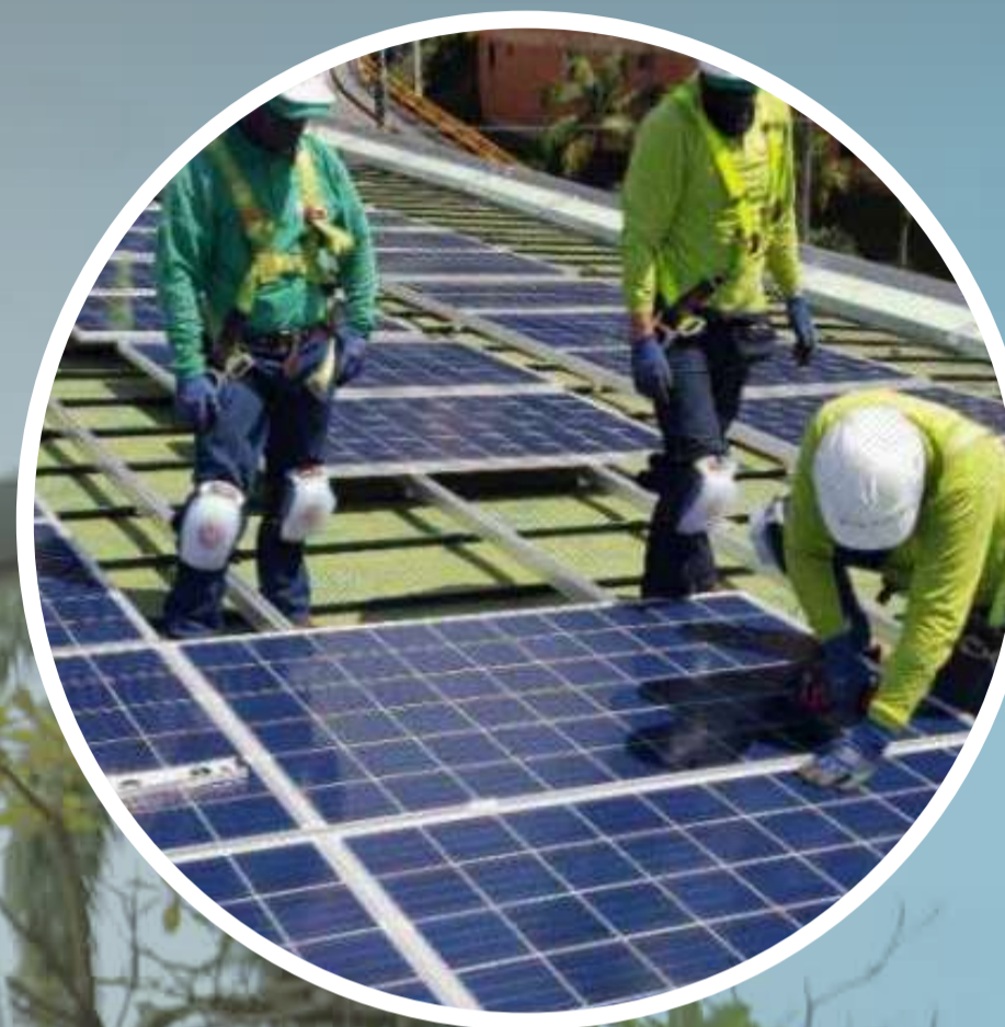
Energía solar Mina La Margarita Antioquia
